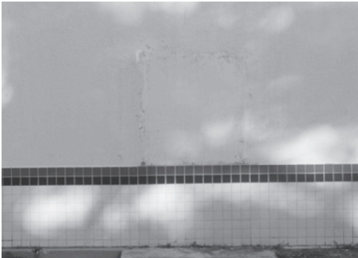
Detalhe de vão de porta fechado pela reforma, na fachada posterior da edificação. Fonte: Arquivo CNV
